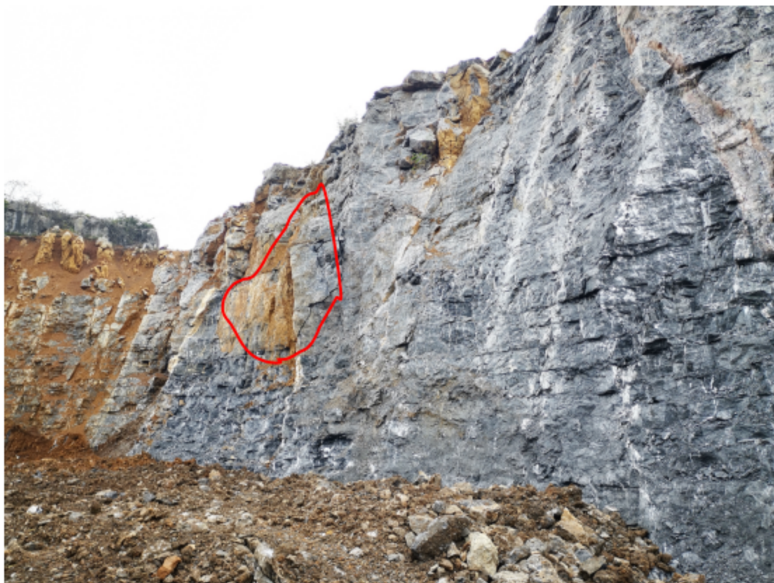
照片 3-3：矿界 4 号拐点南侧边坡危岩体悬挂与边坡处
