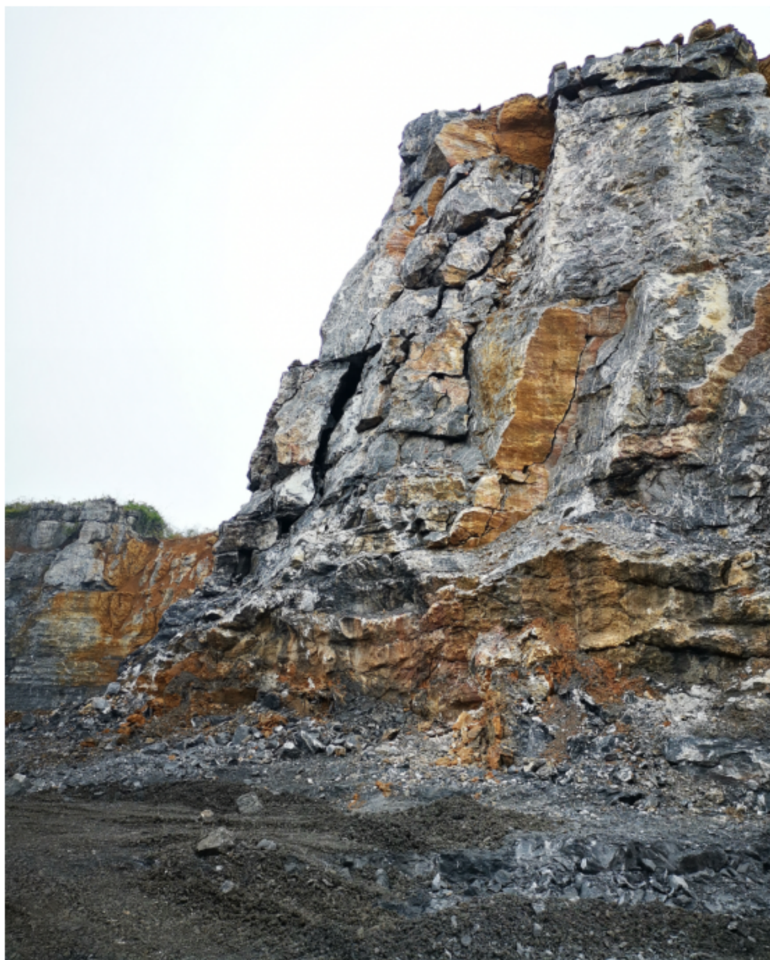
照片 3-2：矿界 4 号拐点处边坡危岩体悬空，岩体受机械振动破裂
