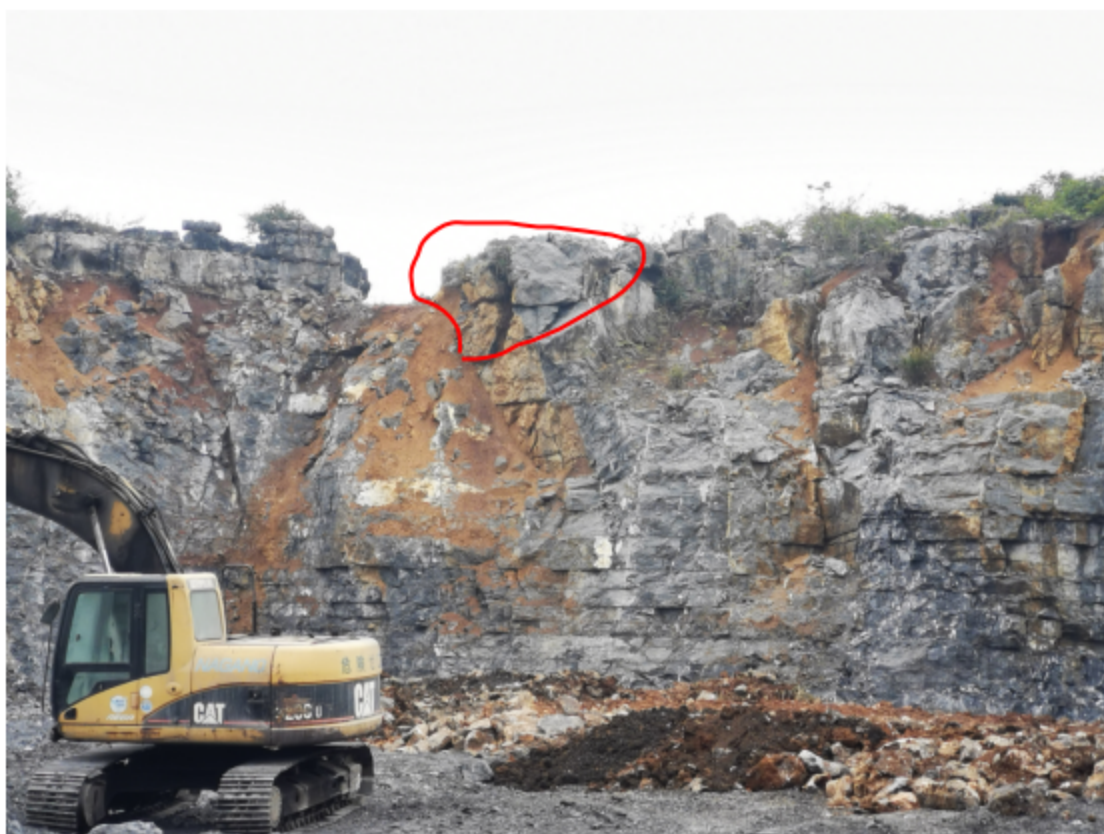
照片 3-4：矿界 2-3 号拐点间采坑边坡坡顶危岩体外凸临空
